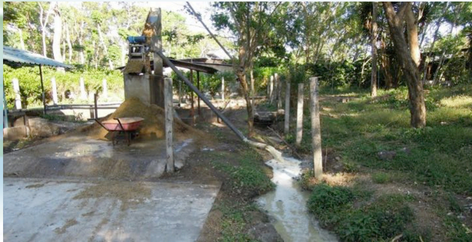
Separador de sólidos de purines de cerdo
